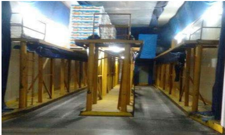
Figura 14. Túneles de Pre-enfriamiento.
